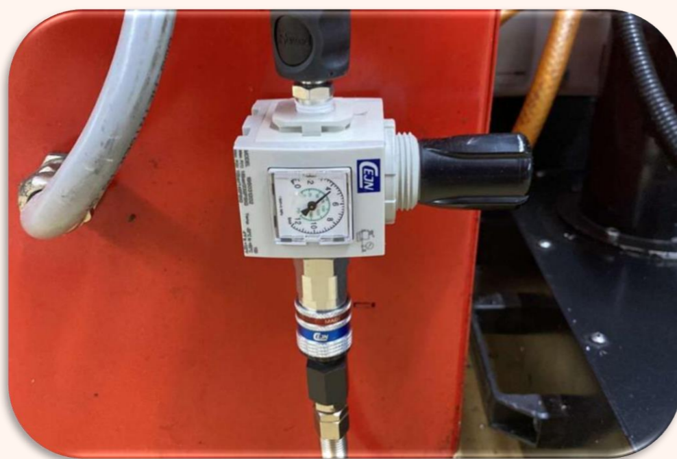
Abb 1: 1. Druckluftregler an der Fräsmaschine
