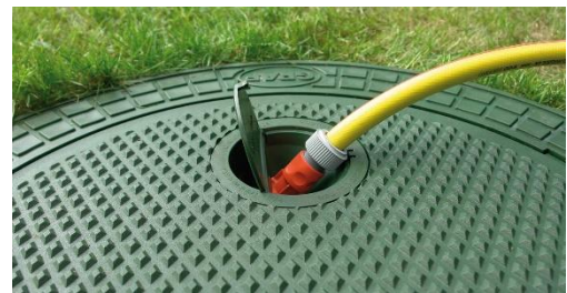
Abb. 4.1.4.8) Interne Wassersteckdose im Deckel des Schachtes
