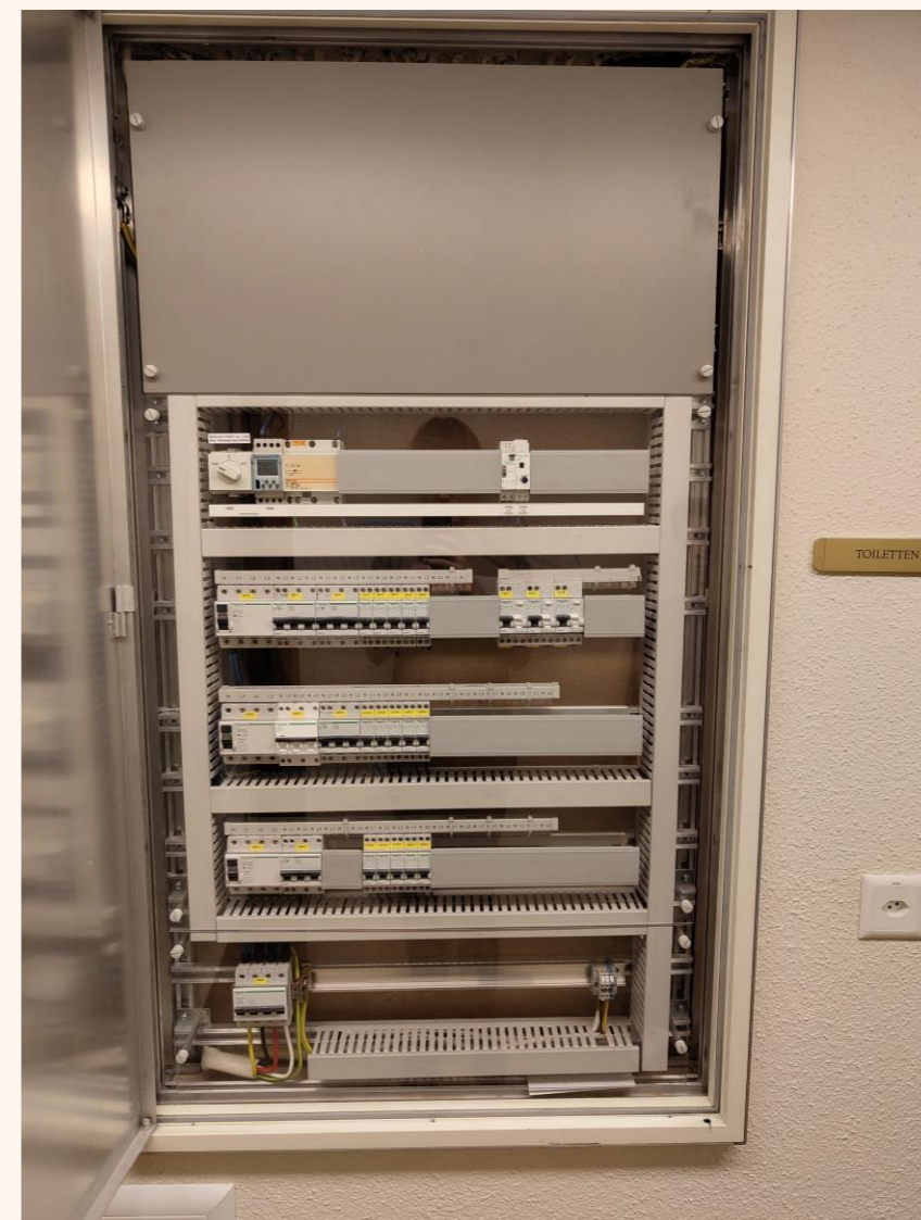
Abb 2: Schaltschrank für Lichtsteuerung (alt)
