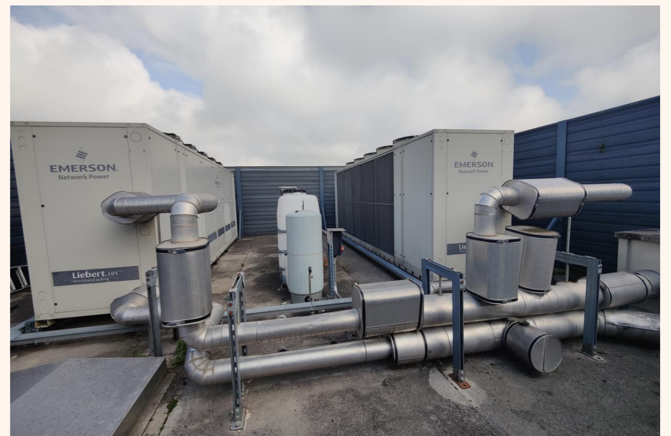
Kühlungsanlage mit Kompressor
