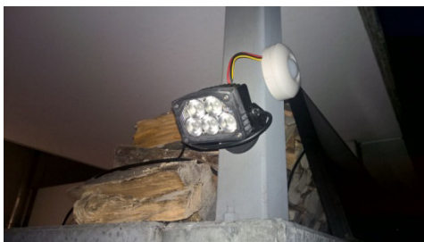
So ist die Lampe und der Sensor befestigt.
