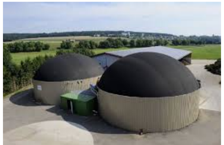
Installation de production de biogaz « La prairie » à Porrentruy.
