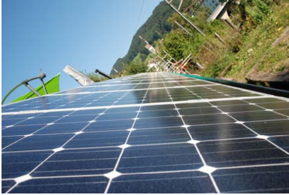
Abbildung 8: Fertige Anlage in Betrieb (Quelle: Eigenes Bild)
