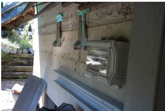
Abbildung 7: Befestigung der Zähler (Quelle: Eigenes Bild)
