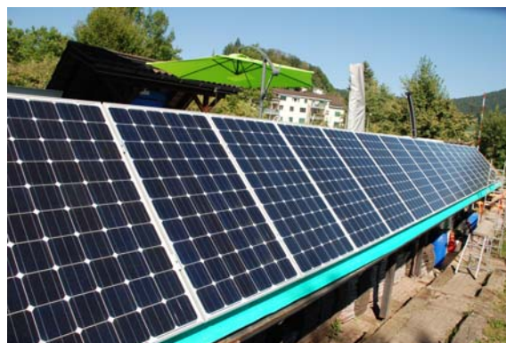
Abbildung 9: Überblick über die gesamte Anlage (Quelle: Eigene Bilder)
