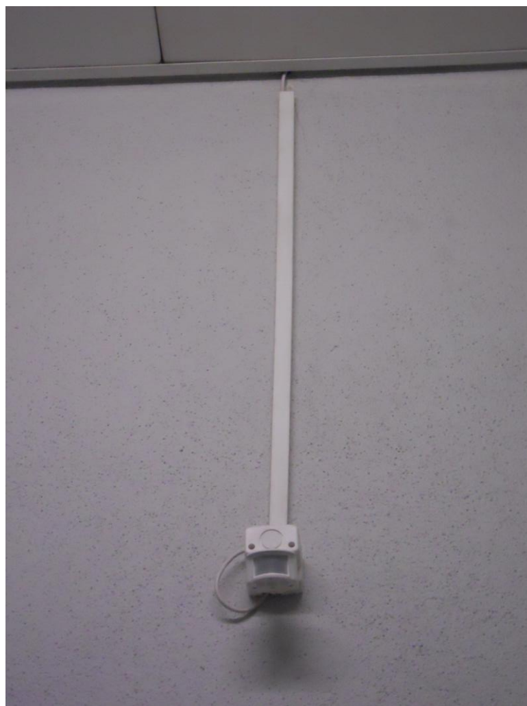
Der 120° Sensor über der Treppe 1
