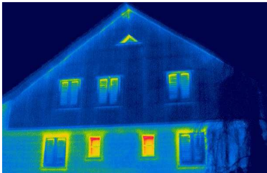
Abbildung 6: Thermographie Bilder aufgenommen durch Ibih AG am 25.02.2012, 03:51 Uhr
