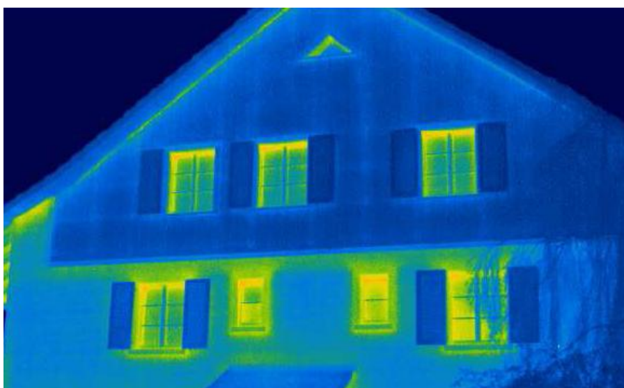
Abbildung 7: Thermographie Bilder aufgenommen durch Ibih AG am 24.02.2012, 20:53 Uhr
